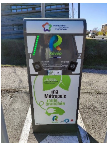
PHOTO 39 : Borne de recharge publique
