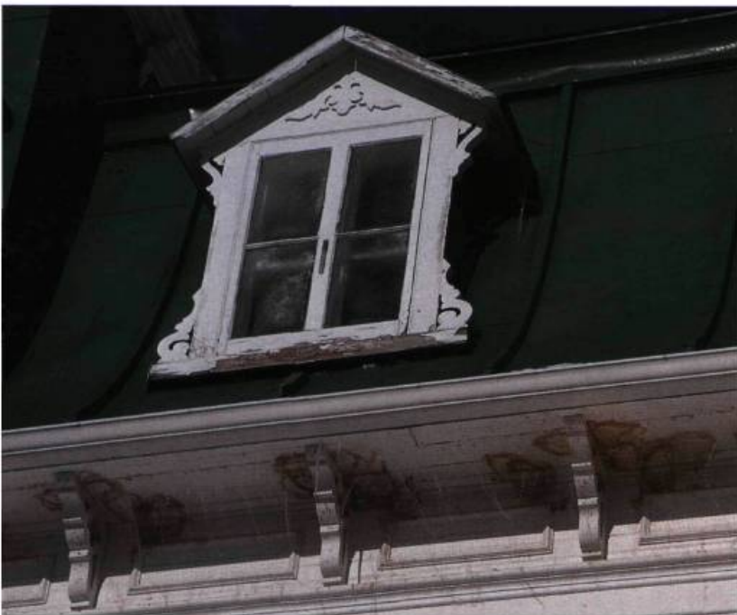
Des traces d'infiltration d'eau perceptibles sous une corniche de bois indiquent un mauvais fonctionnement des solins et un manque d'étanchéité de la toiture près de l'égout.
