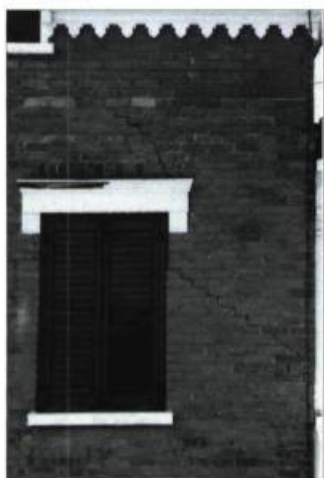
La présence de fissures dans le parement de maçonnerie indique un ou des problèmes auxquels on doit apporter les bons correctifs. Au nombre de ces problèmes, les mouvements du sol, l'expansion et la contraction dues au gel et au dégel.
