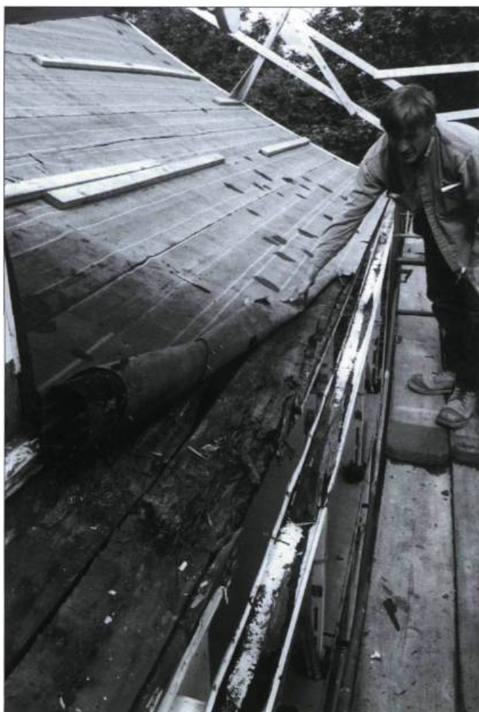
Lors du curitage de la couverture, en août 1998, le bardeau d'asphalte découvert sous le bardeau de cèdre révèle le platelage de bois putréfié.
