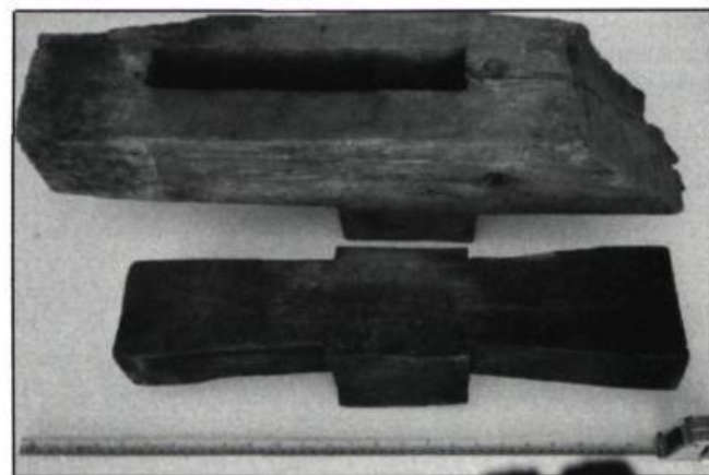
4. Illustration d'un sabot (en haut) et d'une clé (en bas) récupérés à la suite d'un curetage. Le sabot mortaisé reçoit l'extrémité du chevron et la clé taillée en double queue d'aronde retient entre elles les sablières. (photo: F. Varin)
