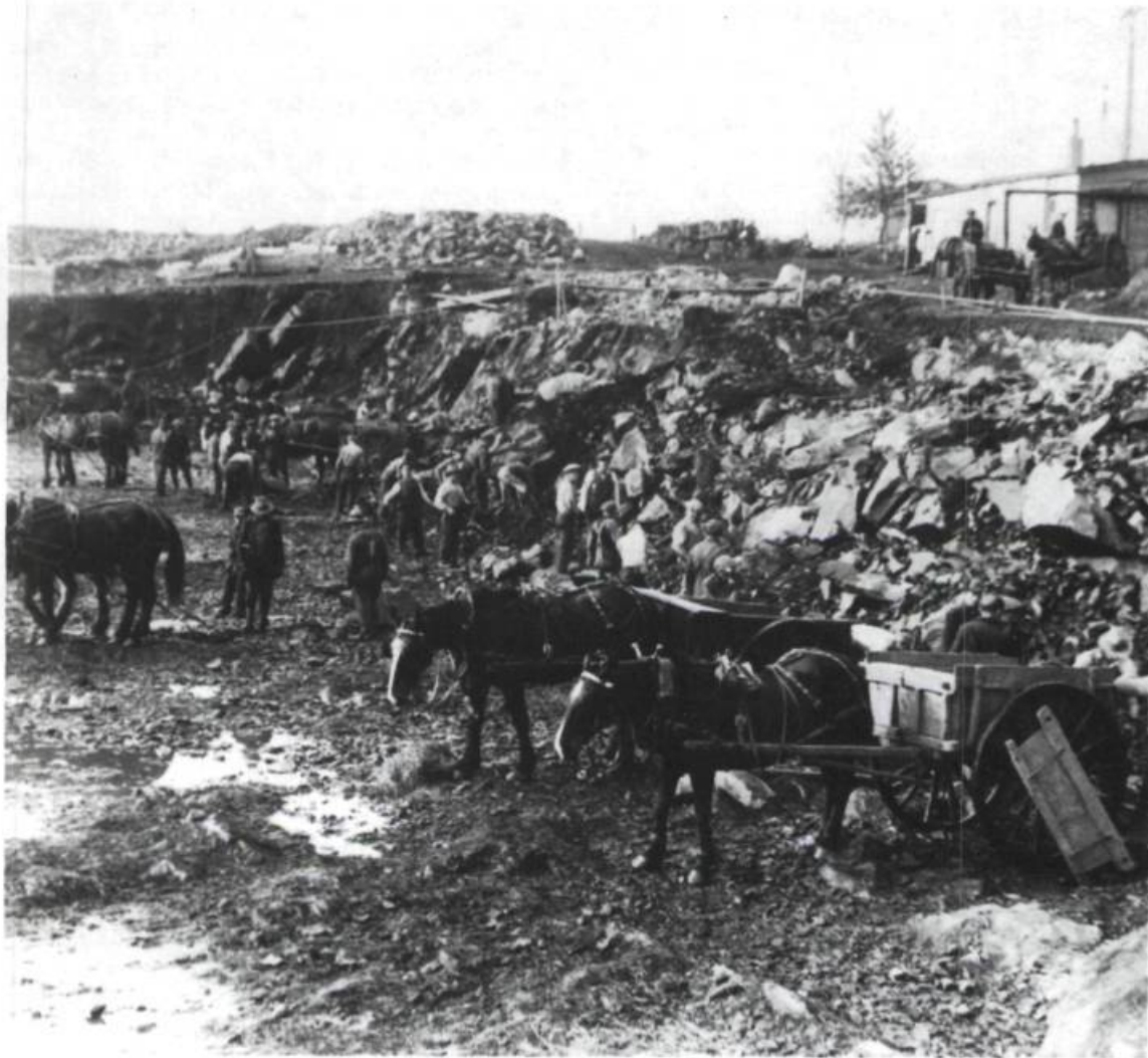
Pour combattre le chômage durant la crise, la ville de Québec entreprend de grands travaux. La construction du réservoir de l'aqueduc sur les Plaines d'Abraham en 1931. Archives de la ville de Québec.
