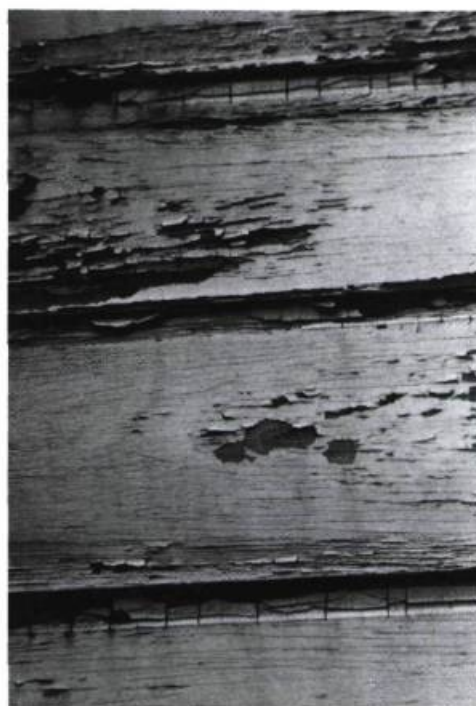
F La peinture qui pèle, l'écaillement et le fendillement jusqu'au nu du bois commanderont un décapage et un grattage importants.
