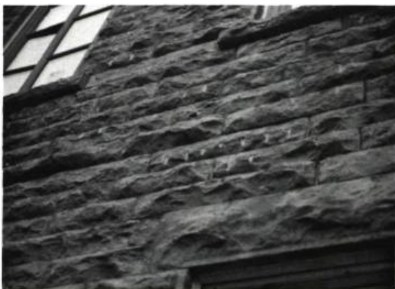
I J Marques laissées par le jet de sable, illustrant les effets nocifs de ce procédé et la mutilation irréversible des éléments de pierre.
