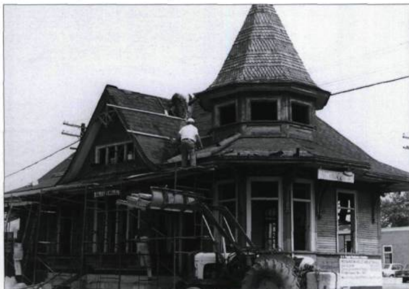
La gare en voie de rénovation à l'été 1983. (Archives de la Société de la gare, Acton Vale).
